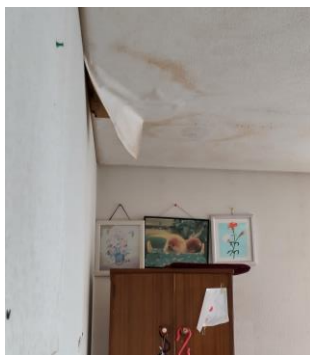
天井のクロスが剥がれて 水が入ってきました
